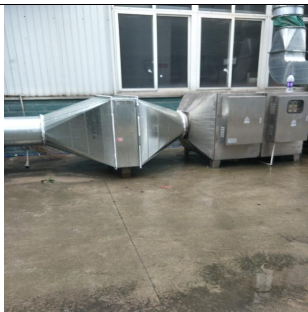
喷漆废气处理设施（活性炭+UV 光解）
