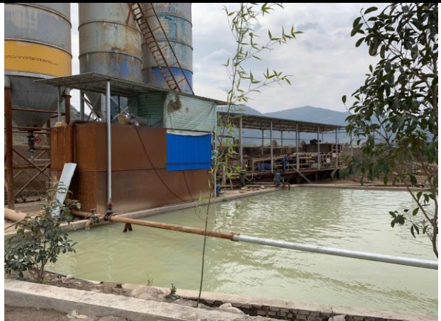
清水池+污泥浓缩塔
